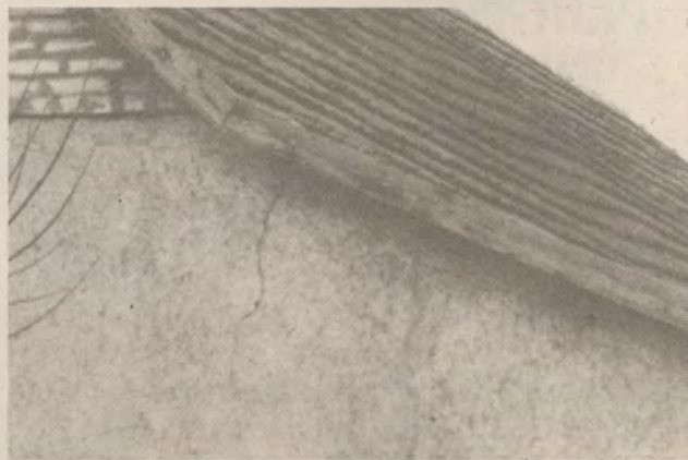
A képen jól látható az a repedés, ami annyi fejfájást okozt Gazdag Eleknek.
